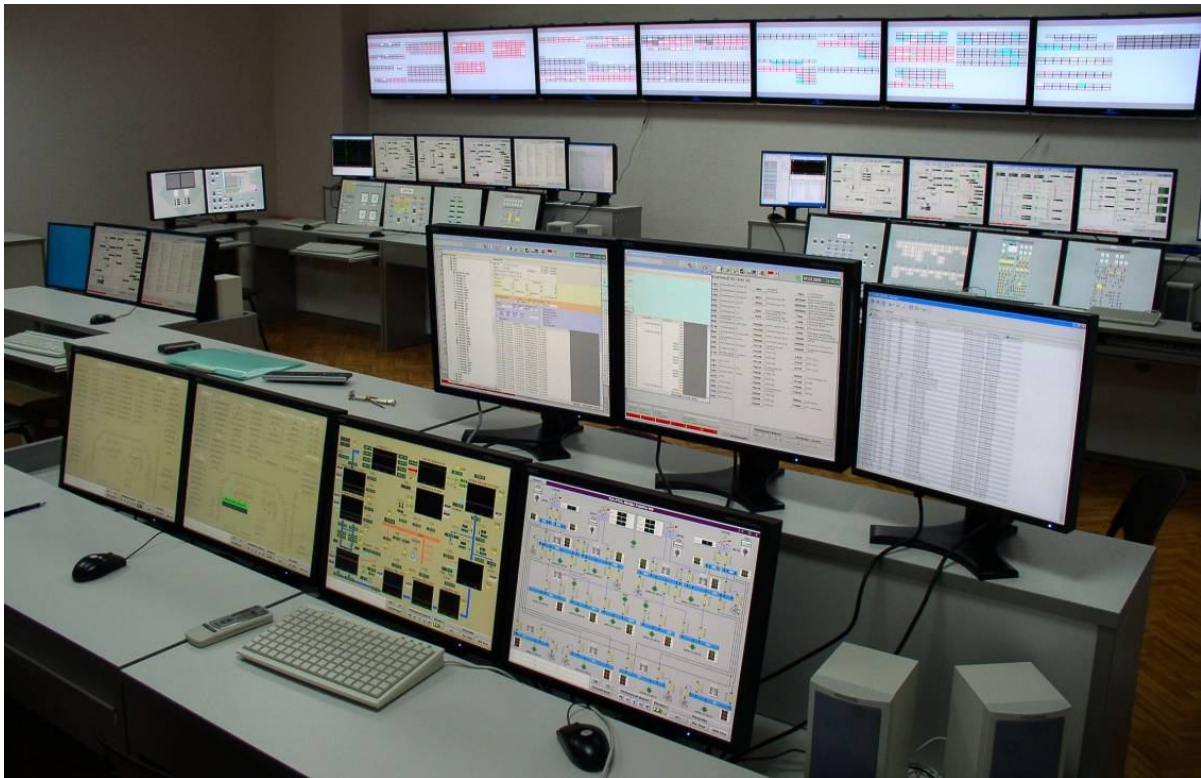
Рис.3. ТОС АСУТП 2-го энергоблока Ростовской АЭС.
