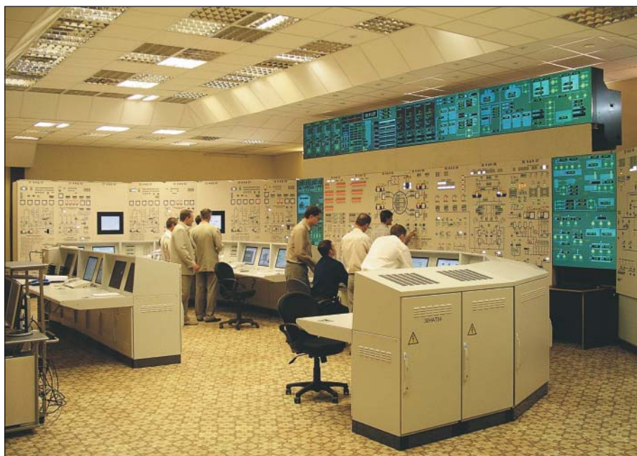
Рис. 1. Блочный щит управления ПМТ АЭС с реактором ВВЭР-1000
